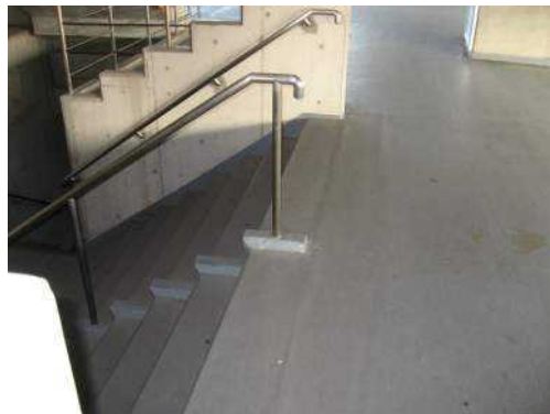
地下への階段の造り（転落の可能性あり）
